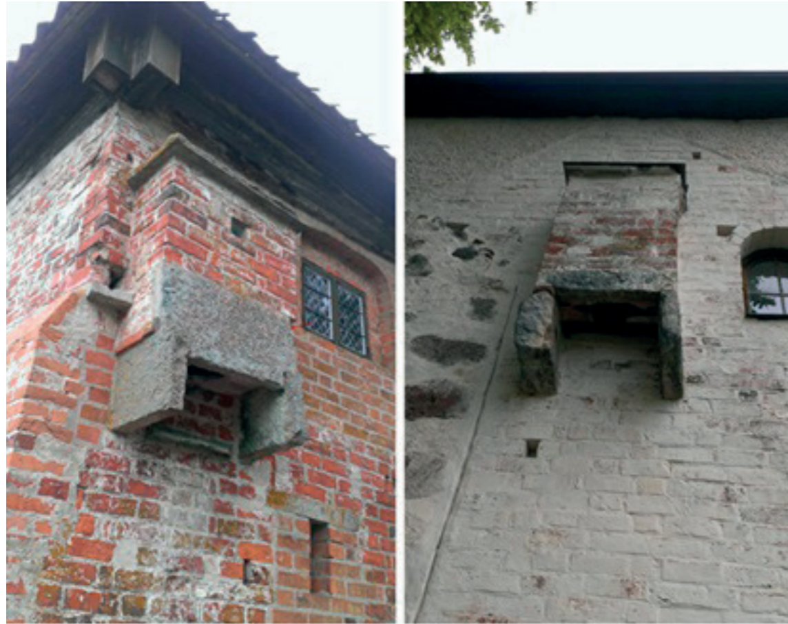
รูปที่ 6 ห้องส้วมแบบยื่นออกนอกอาคารยังพบเห็นตามอาคารทั่วไปในเมือง
